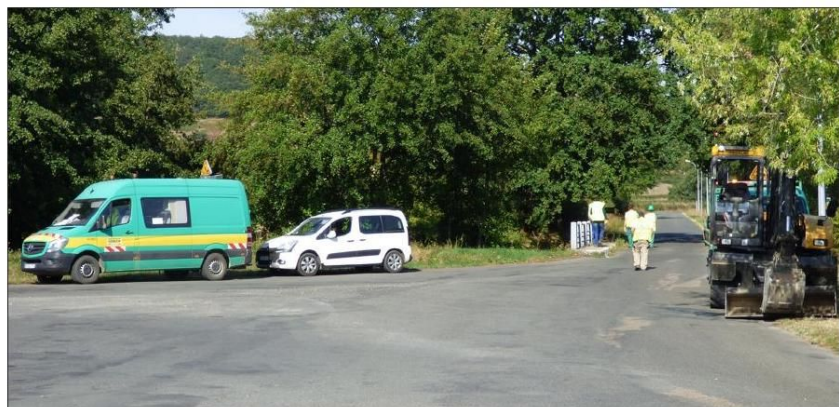
■ Mercredi, la société Sobeca poursuivait le tracé des futures tranchées à la sortie du lotissement de la Corne, au bout du boulevard Jean-Mermoz à Gueugnon. Photo Alain LARDRY
